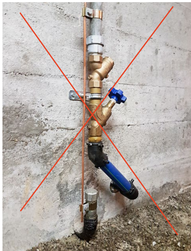
A ne pas faire : pontage de la mise à terre sur l'ancien branchement
